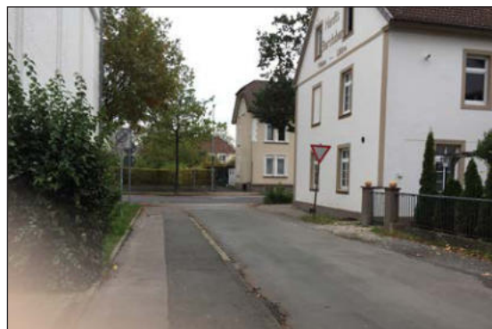
Abb. 90: Mangelhafter Zustand der Wege am Technikum (Bleichenweg)
